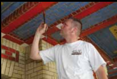
▲ Henk Scholten van Wolters & Ovink brengt rode lijnolieverf aan in de theekamer.
